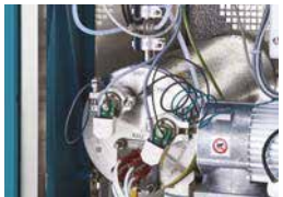
FVG - Steam generator FVG - Dampferzeuger
