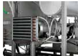
Condensate drain cooler and vacuum pump / Kondensatablaufkühler und Vakuumpumpe
