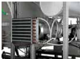
Condensate drain cooler and vacuum pump / Kondensatablaufkühler und Vakuumpumpe
