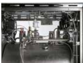
Modulating valve on steam inlet Valvola modulante nell'ingresso vapore
