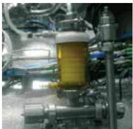
Decontamination of exhaust air with sterile filter / Decontaminazione dell'aria di scarico con filtro sterile
