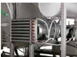
Condensate drain cooler and vacuum pump / Raffreddamento della condensa sullo scarico e della pompa del vuoto
